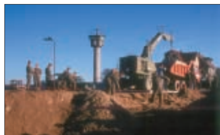
Provisorische Wiederherstellung der Brücke über die Ecker im Zuge der B 6/F 6 Stapelburg – Eckertal am 12.11.1989
